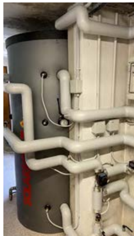
Sottostazione uffici e lavanderia: puffer di alimentazione dell'impianto di riscaldamento e produzione acqua calda sanitaria
